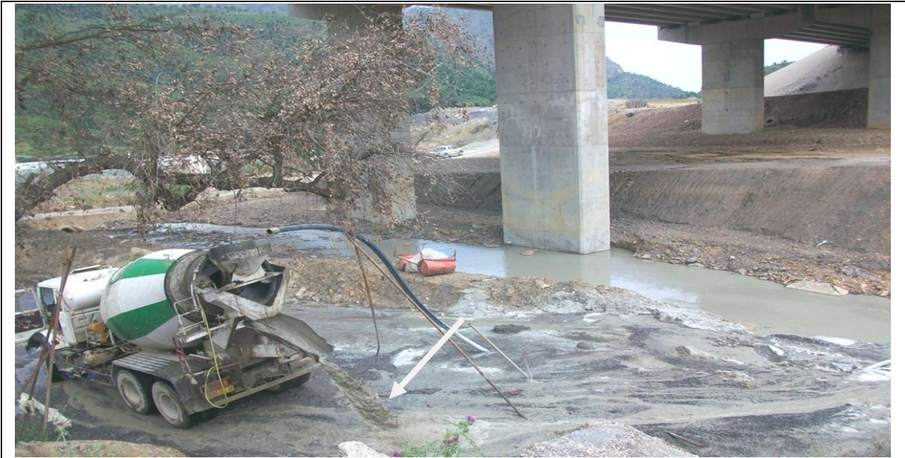
Figure n° (7) : Lessivage au niveau d'Oued Bouzegza (proche centre de béton).
