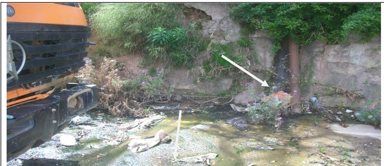
Figure n° (16) : Eaux usées rejeté dans le milieu naturel. (Base de vie d'Ouled ouali).
