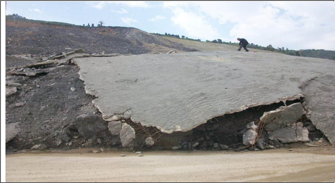
Figure n° (4) : Glissement de terrains à grand échelle.
