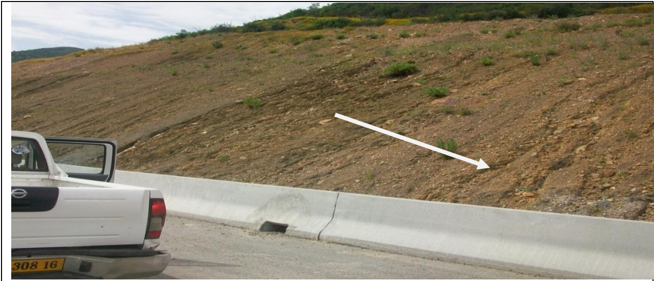
Figure n° (3) : Phénomène d'érosion à cause de manque de la végétalisation des talus.
